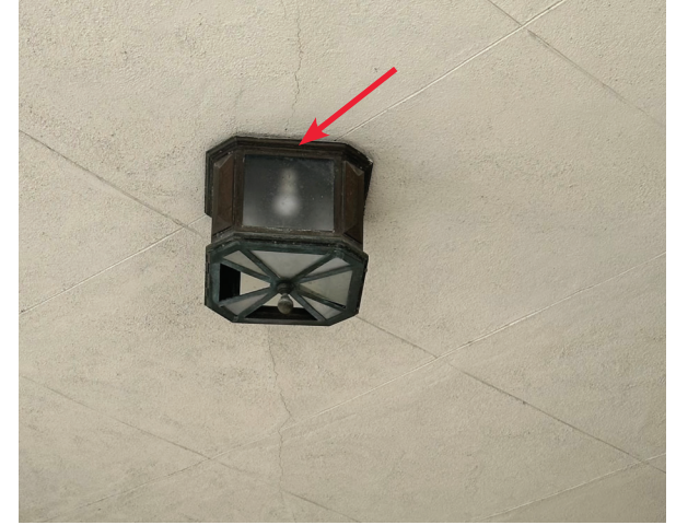
A11-2 - REPAIR PORTICO CEILING STUCCO
